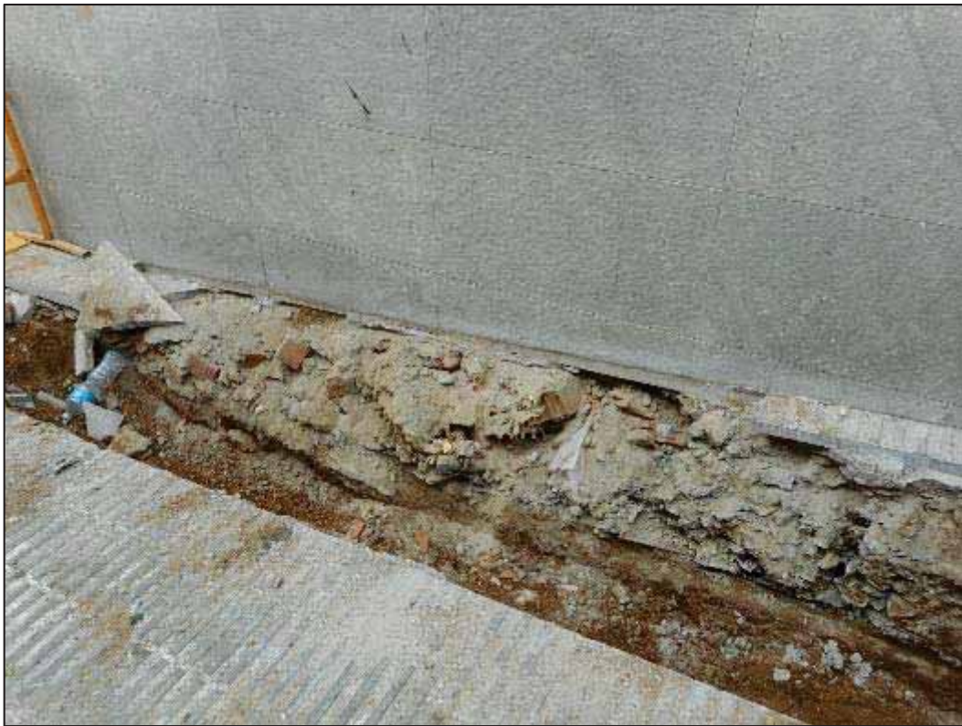
14. Treballs d'obertura en rasa a la Baixada de la Glòria, entre el passatge d'Espíria i el carrer de la Mare de Déu del Coll.
