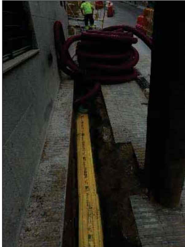
19. Treballs d'obertura en rasa a la Baixada de la Glòria, entre el passatge d'Espíria i el carrer de la Mare de Déu del Coll.
