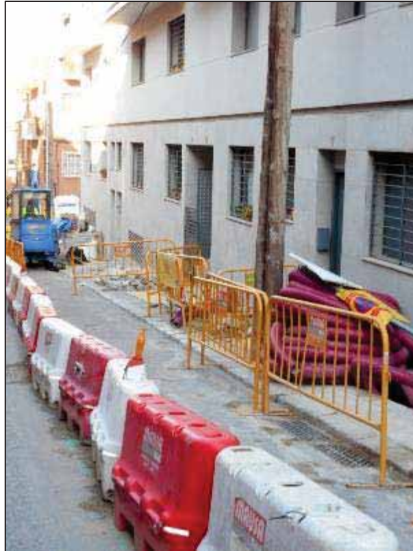
9. Treballs d'obertura en rasa a la Baixada de la Glòria, entre el passatge d'Espíria i el carrer de la Mare de Déu del Coll.
