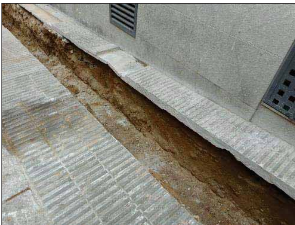
18. Treballs d'obertura en rasa a la Baixada de la Glòria, entre el passatge d'Espíria i el carrer de la Mare de Déu del Coll.
