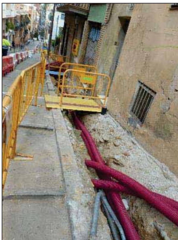
2. Treballs d'obertura en rasa a la Baixada de la Glòria, entre el carrer del Repartidor i passatge d'Espíria, anteriors al control.
