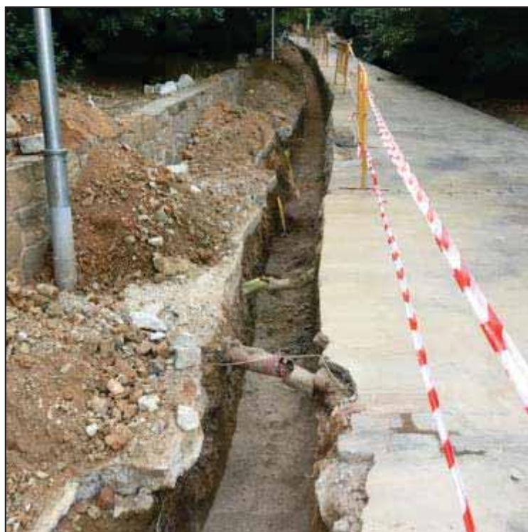
12. Rasa realitzada al camí d'accés al Park Güell des del carrer del Torrent del Remei. Presència de diferents seveis que travessen.
