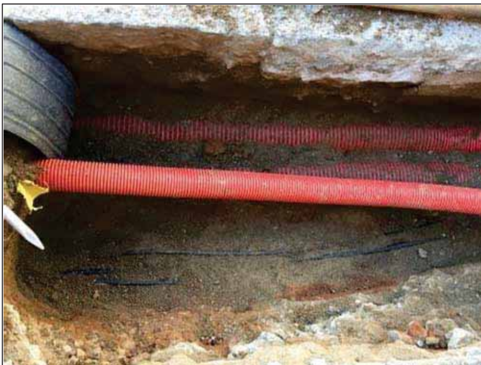
48. Cala acabada de rebaixar. Al fons, la continuació dels cables aeris que ja estaven soterrats.
