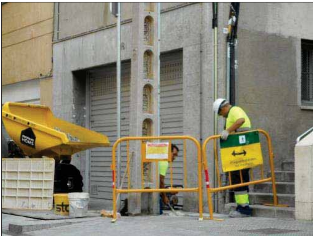
28. Treballs de soterrament de línia telefònica a la cantonada nord-oest del carrer de Verdi.
