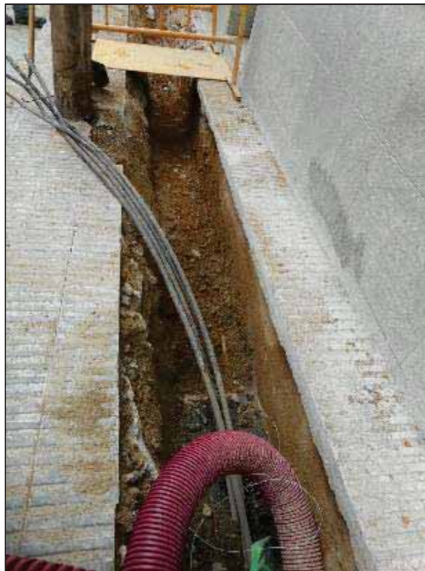
12. Treballs d'obertura en rasa a la Baixada de la Glòria, entre el passatge d'Espíria i el carrer de la Mare de Déu del Coll.
