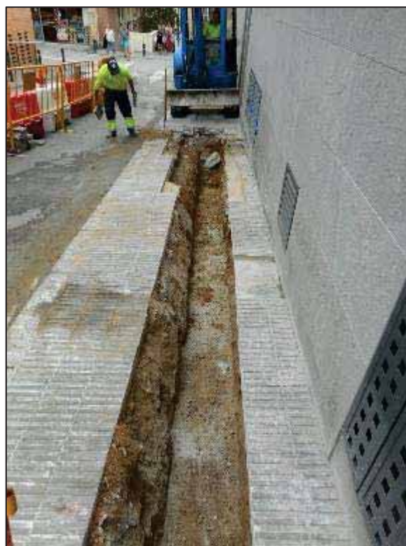
16. Treballs d'obertura en rasa a la Baixada de la Glòria, entre el passatge d'Espíria i el carrer de la Mare de Déu del Coll.
